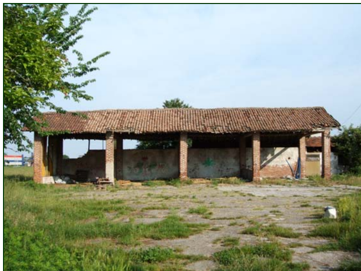
Viste dello stato attuale della Cascina Cicogna con alcuni dei volumi da recuperare
